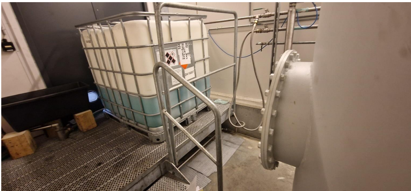
Opbevaring af flydende råvarer i pallettank i olietankbygningen, som er lavet med spildsikring.
