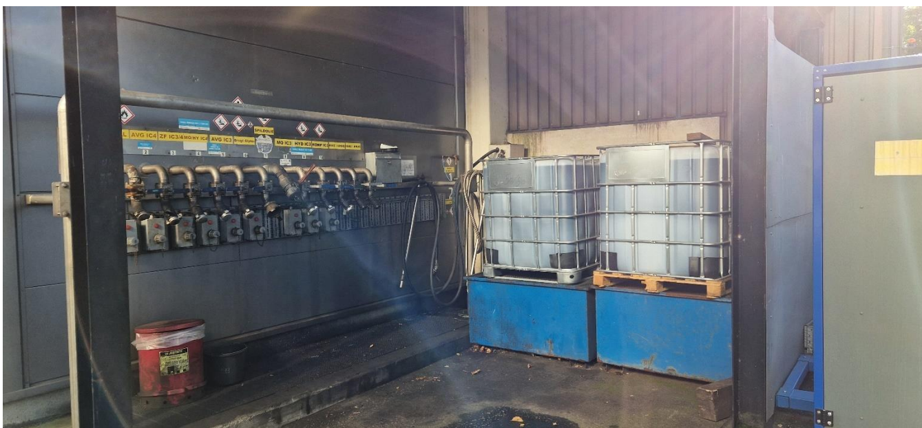
Opbevaring af flydende råvarer/affald med spildsikring ved påfyldningsstudse til olietankbygningen.
