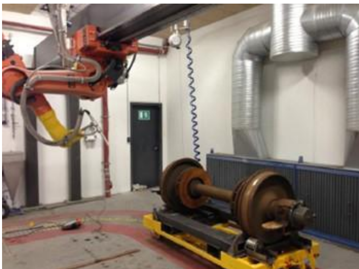
Automatiseret maleanlæg i malekabinen (billedet er fra tilsyn i 2021).
