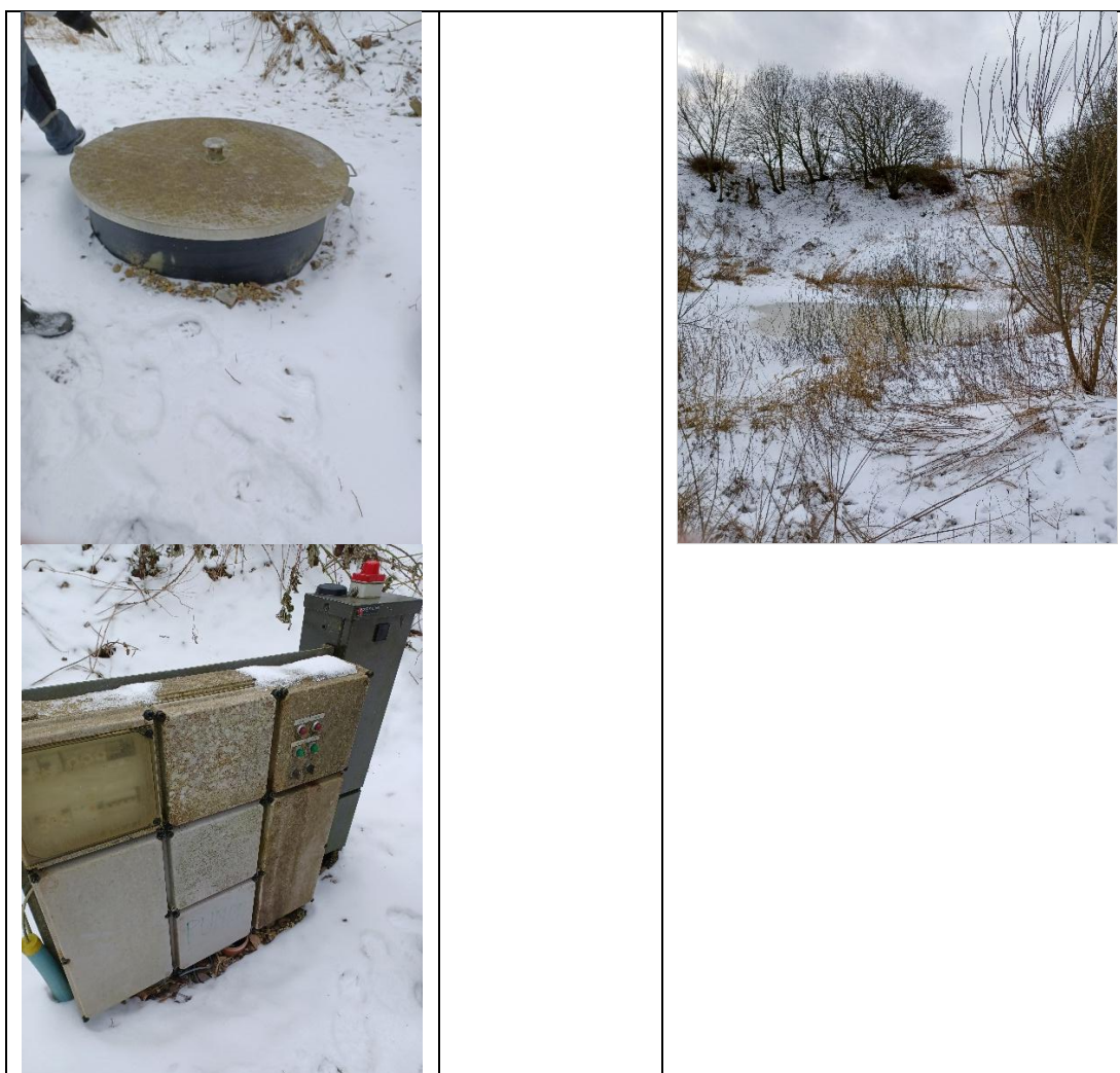
Billedsamling 2. Pumpen og omfangsdræn til overfladevand fra den tidligere komposteringsplads og det gravede bassin der benyttes til opsamling af overfladevand.
