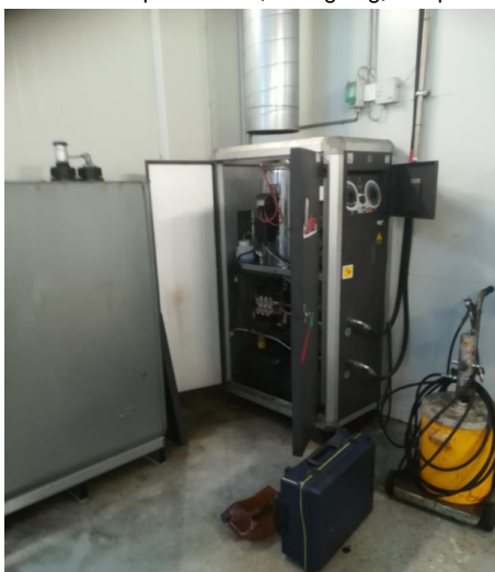
Billede 10. Spildolietank, udsugning, kompressor
