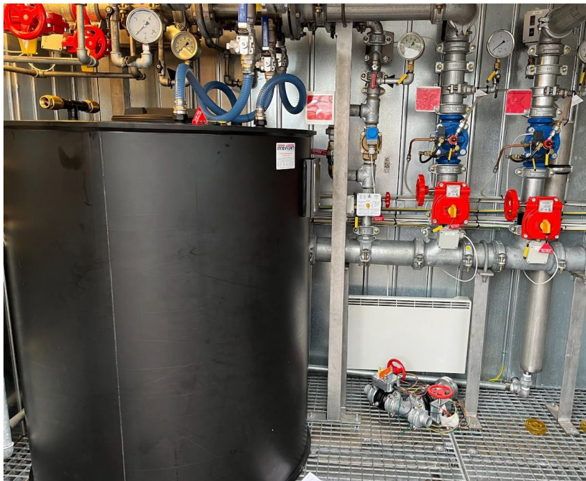
Skumanlæg i container med opsamlingskar under tanken
