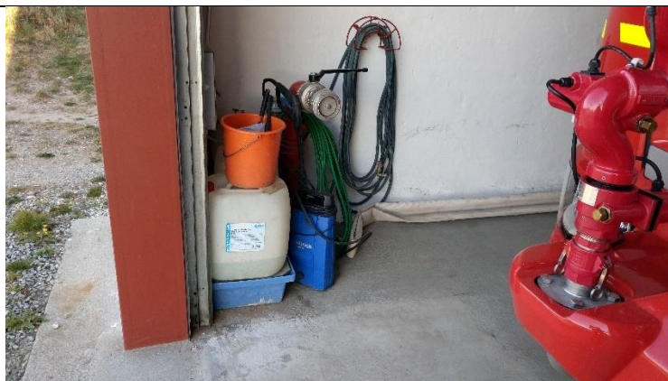
Billede nr. 2: Opbevaring af autosæbe ved doseringsanlægget
