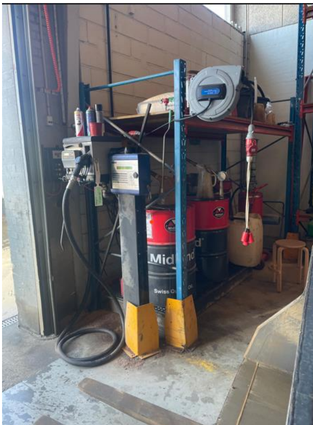
Billede 3. Optankningssted. Dieseltønden er placeret på spildbakke med rist.
