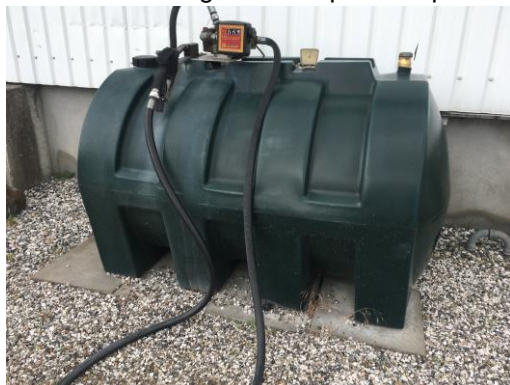
Tank 2 placeret på fliser
