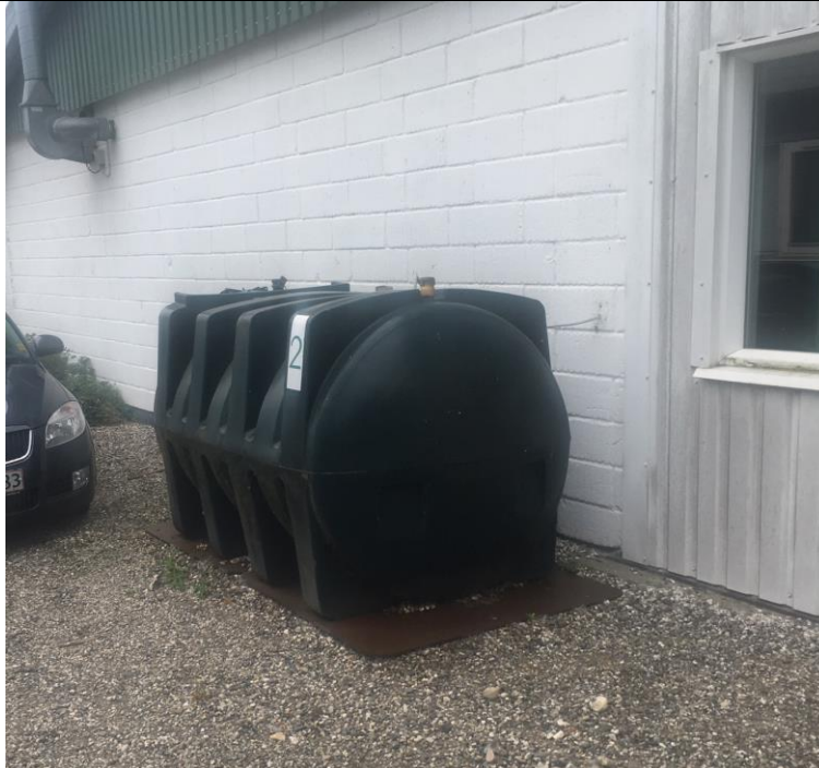
Billede nr. 10: Fyringsolietank (tank nr. 3).
