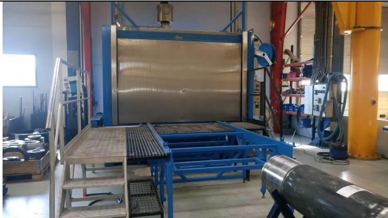
Billede nr. 5: Ny større vaskemaskine i kW-gearværksted
