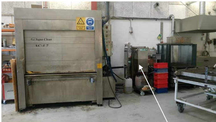
Billede nr. 6: Vaskemaskine i kW-gearværksted. Båndfilter til vaskemaskine
