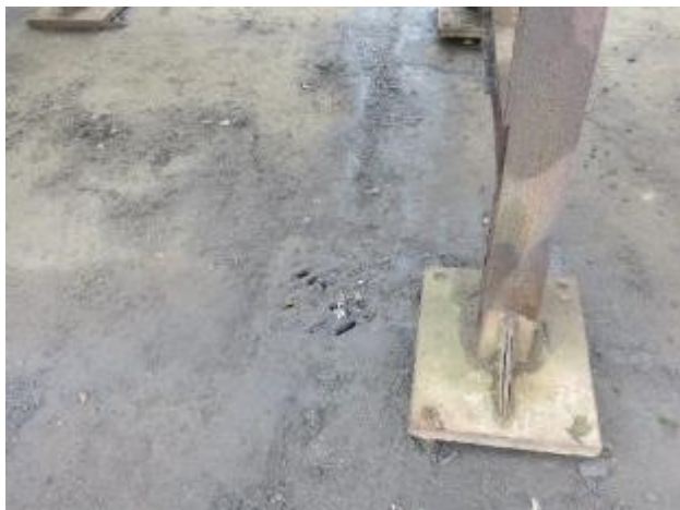
Afløb er delvist blokeret af opslæmmet materiale. Opslæmmet materiale der også
