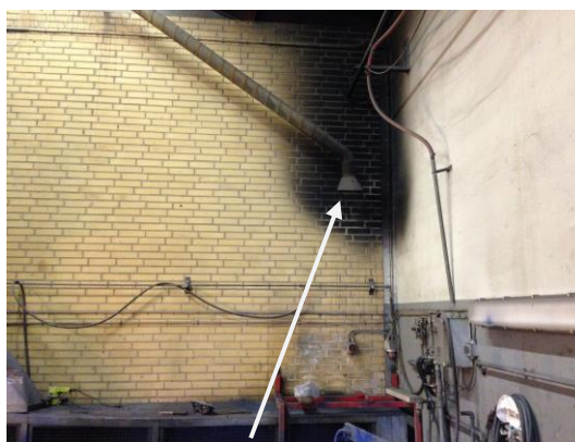
Billede nr. 4 - Udsugning fra udstødning fra højtryksrenser (2013).
