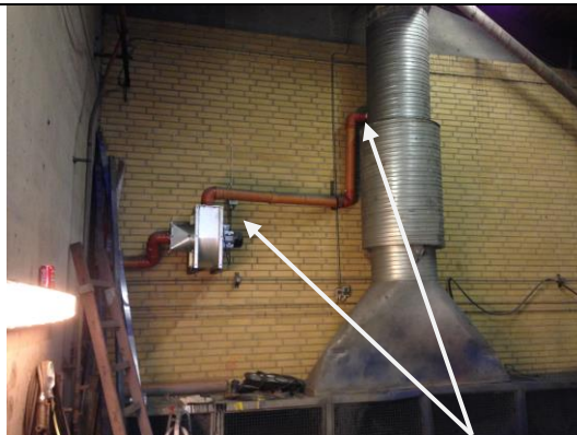
Billede nr. 3 - Udsugning fra vaskehal og tilkobling fra værksted (2013).
