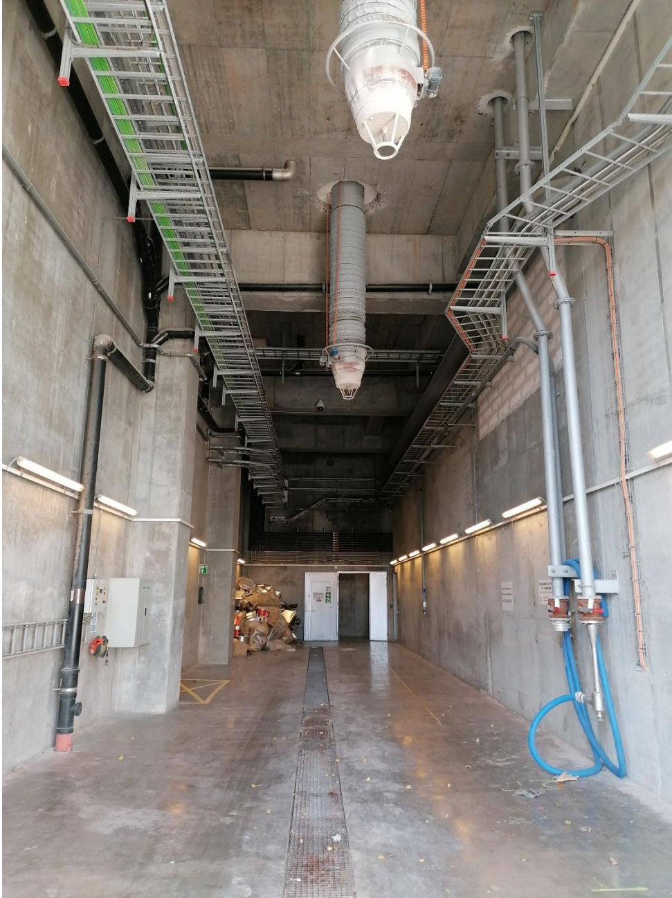
Afhentning flyveaske. Udløves gennem lukket system under loftet
