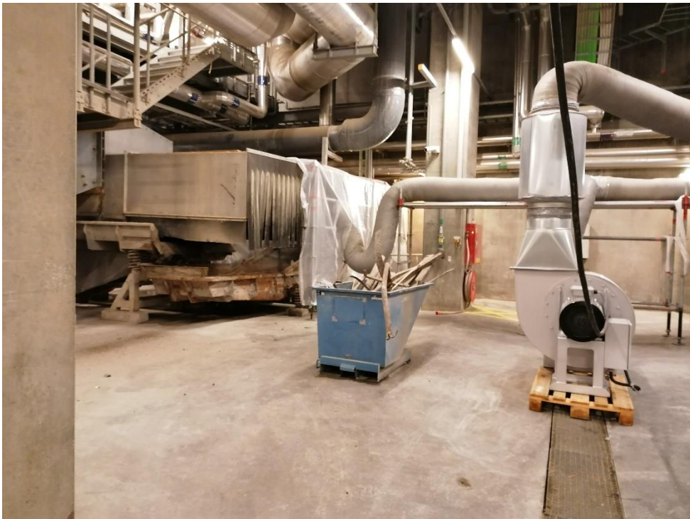
Slaggekælder. Slaggeudtag fra ovnen i container til venstre.
