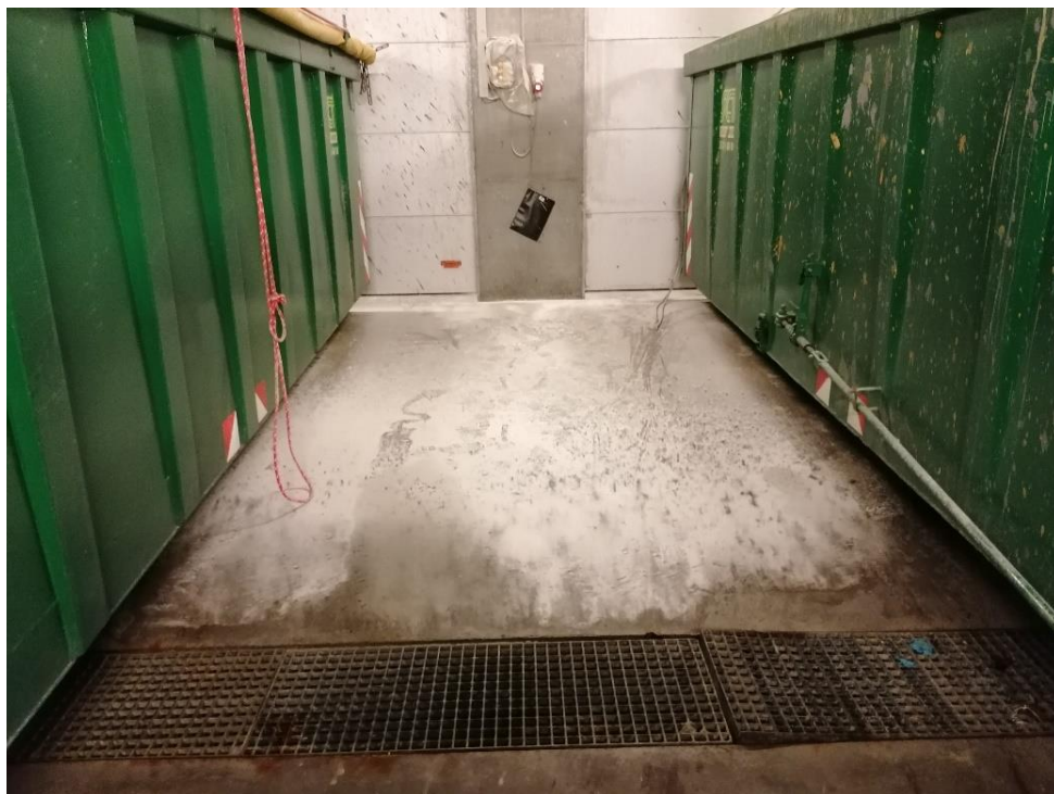
Nedløb til internt spildevandssystem
