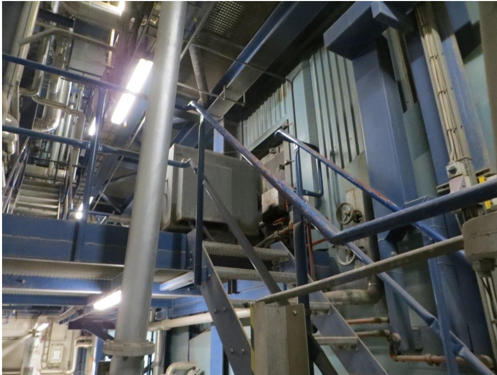
Rør til recirkulering af kedelaske. Bagved ses den ene af to støttebrændere (firkantet kasse)
