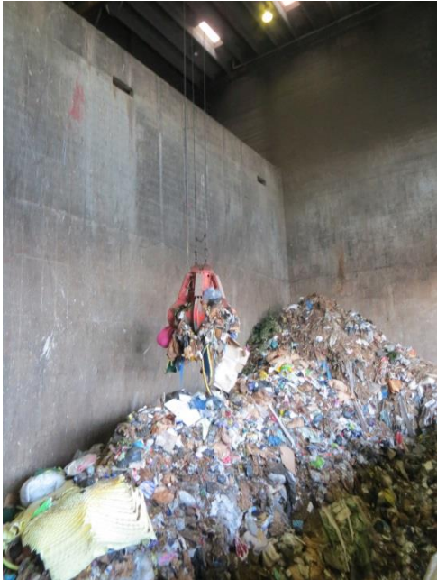
Affaldssilo og kran
