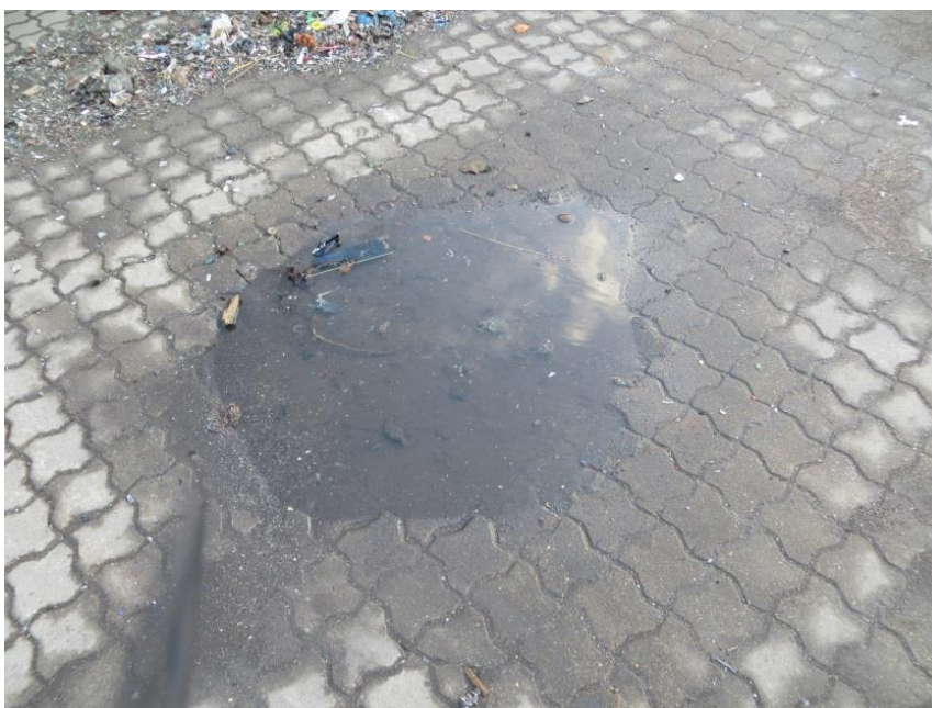
Tilstoppet afløb på pladsen til opbevaring af RDF.
