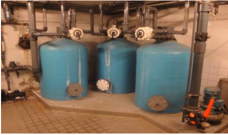
Til filtrering: 3 sandfiltre og 1 kulfilter.
