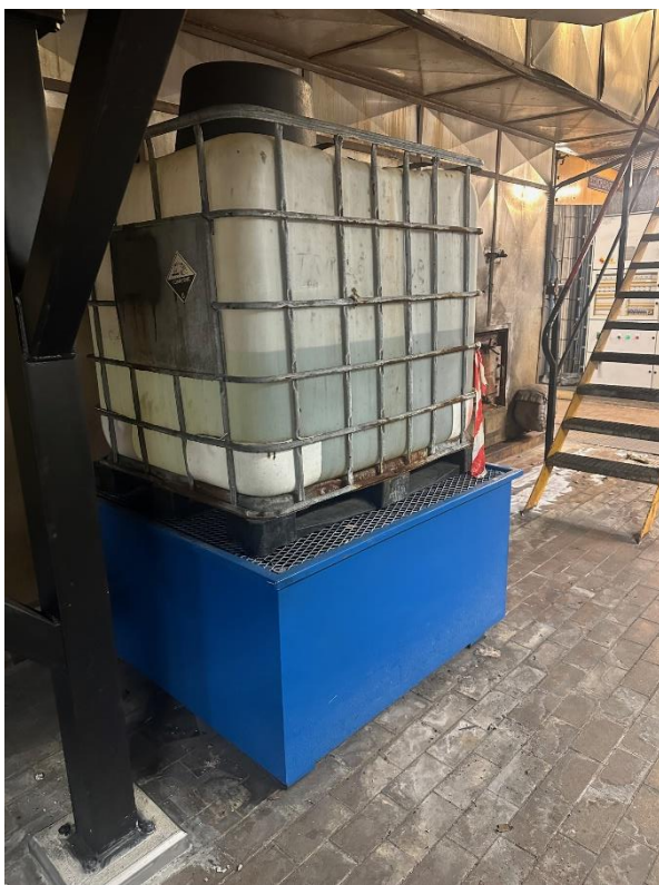
Figur 5: Palletank med saltsyre placeres oven på en spildbakke
