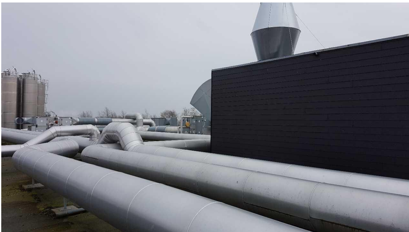
Udsugningsanlæg på produktionsbygningen med flere filterhuse samt et stort Genvex anlæg.
