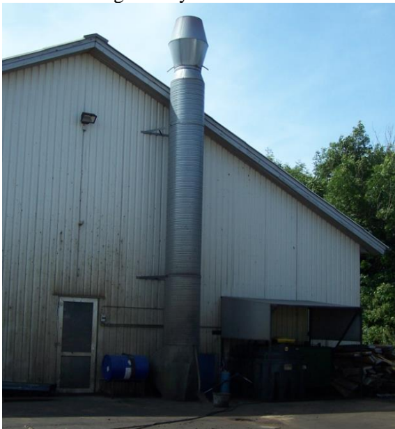
Spildolietank under tag i 2014 - nederst til højre
