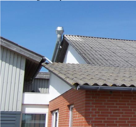
Afkast 3 fra reparationshal og montagehal ført ca. 0,5-1 m over tagryg – 2014.
