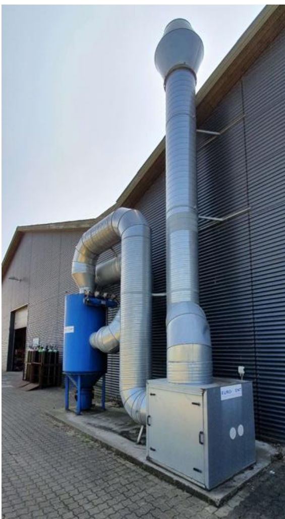
Filteranlæg med luftafkast fra svejsning og slibning.
