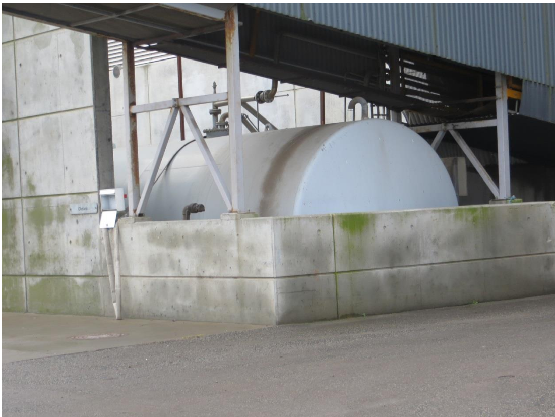
Olietank til støttebrændsel i lukket gård, hvor regnvand pumpes ud manuelt.
