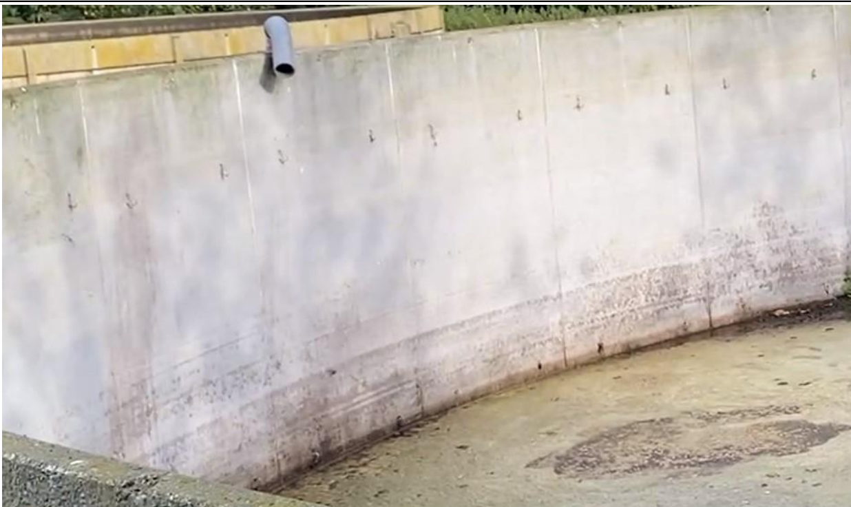
Indløb på den store gyllebeholder
