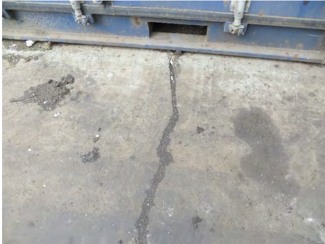
Revne i belægning foran container til opsamling af olie- og kemikalieaffald
