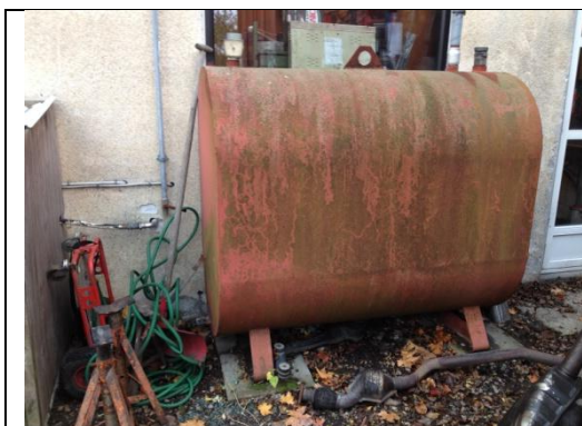
Foto 1 fyringsolietank på ubefæstet areal
