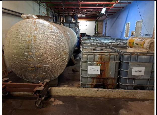
Figur 14. tegn på at der er utætheder enten i loftet eller i opkanten og IBC-beholdere
