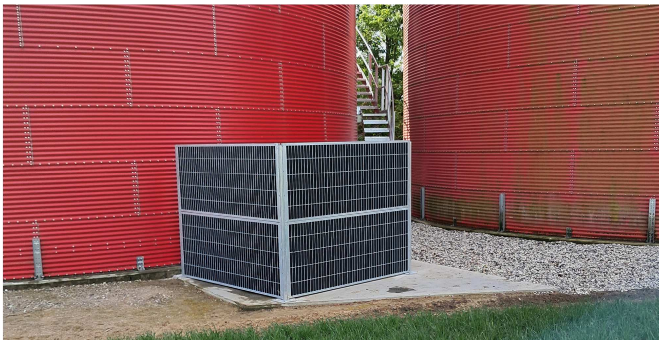
Støjdæmpende hegn omkring blæser ved silo 3
