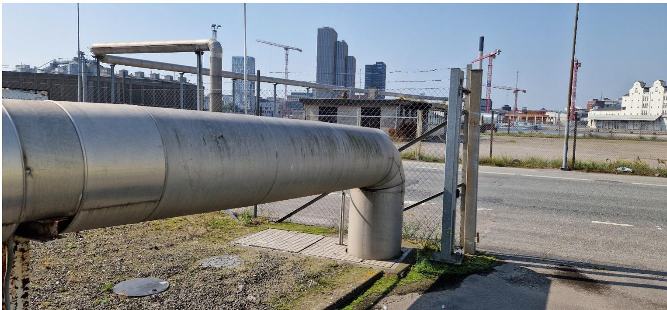
Rørledning fra kaj til indpumpning af produkt til NYNAS's produkttanke er ført under vejen og fortsætter på den anden side til kaj.
