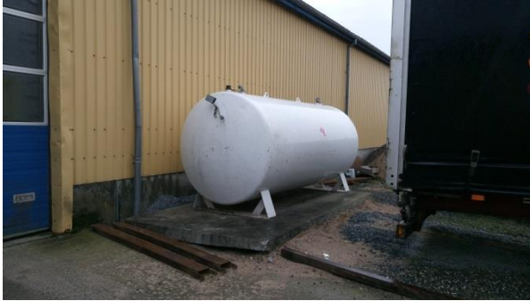
Billede nr. 4: Tank til diesel
