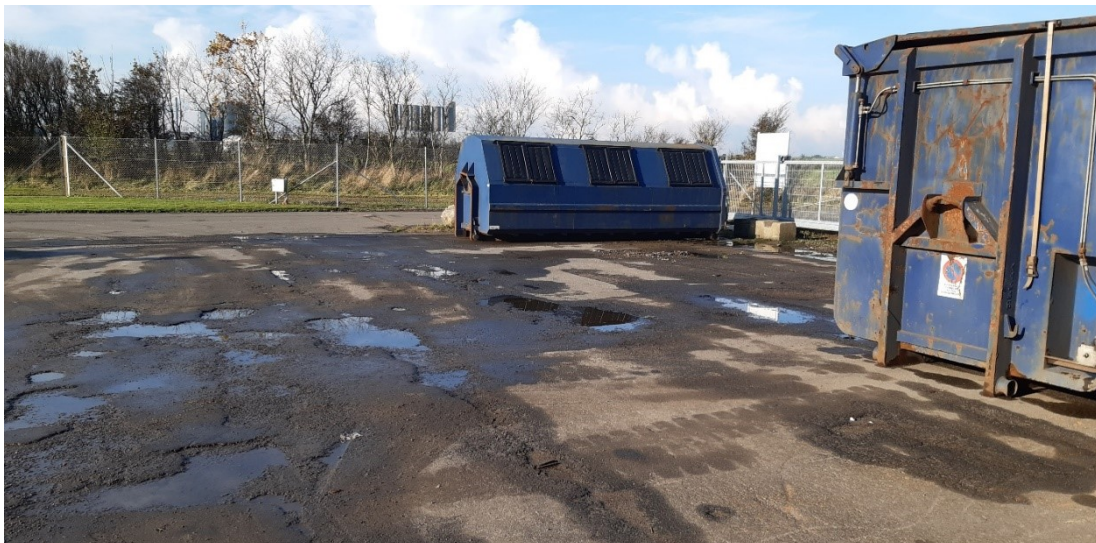
Figur 4. Belægninger. Øverst: Belægningen udenfor den gamle omlastehal. Midterst: Nedbrudte belægningssten. Nederst: Asfaltbelægning ved containere placeret imellem indkørsel og den nye omlastehal.
