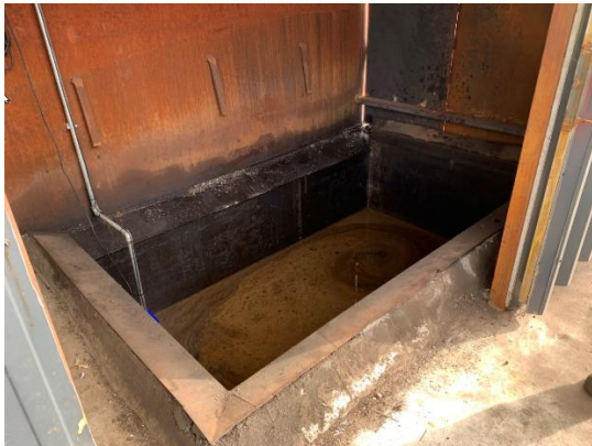
Foto af opsamlingsgrube til opsamling af olie fra de olieholdige spåner. Herfra pumpes olien op i pallettanke på spildbakker.
