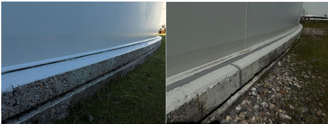
Figur 5. Venstre: Tank T-8856 uden fuge i annularpladen, da den skulle snart inspiceres. Højre: en anden tank, efter out of service inspektion med ny fuge.
