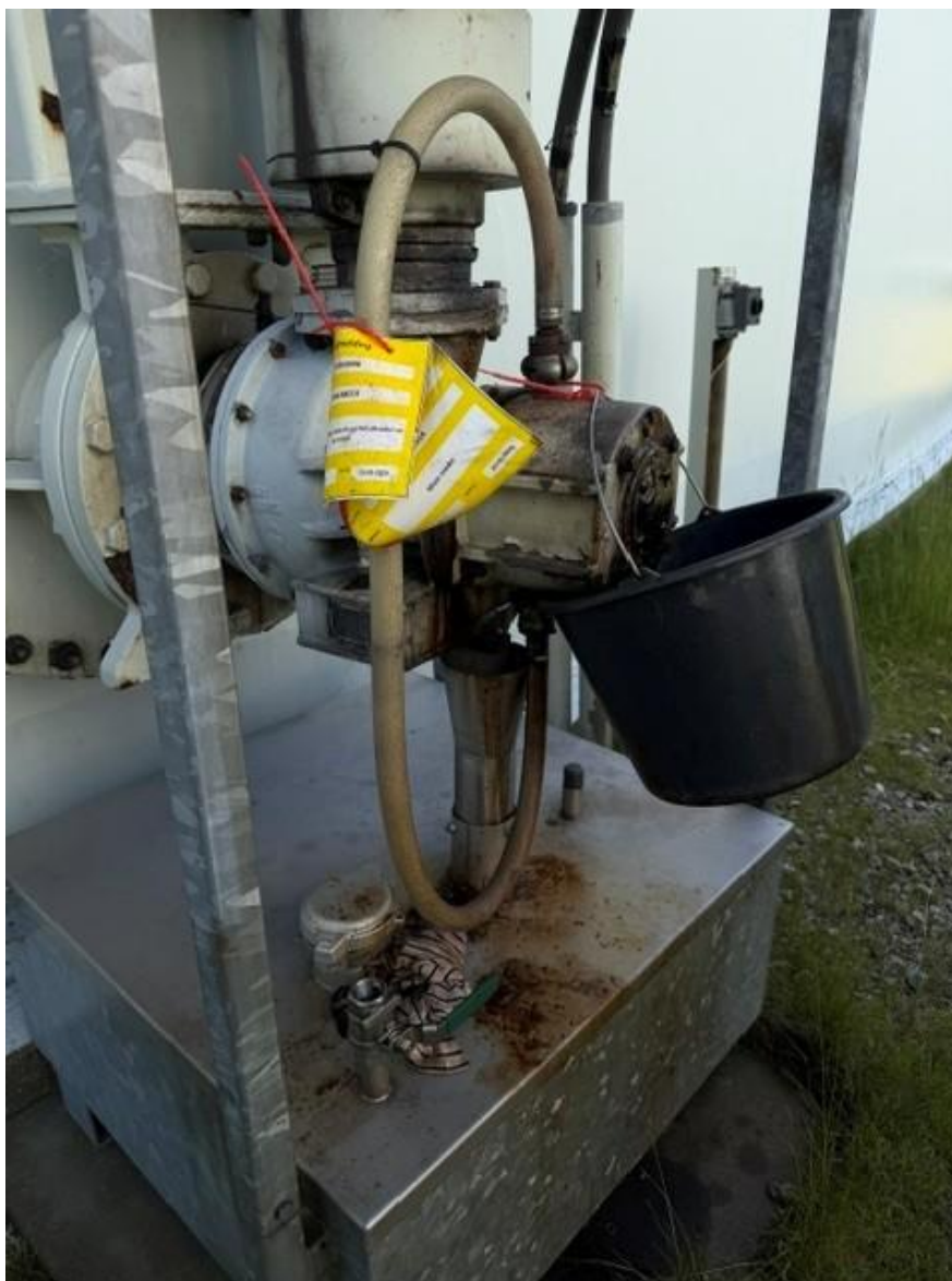
Figur 3. spild under tankmixeren M-8801A ved tank 8801.
