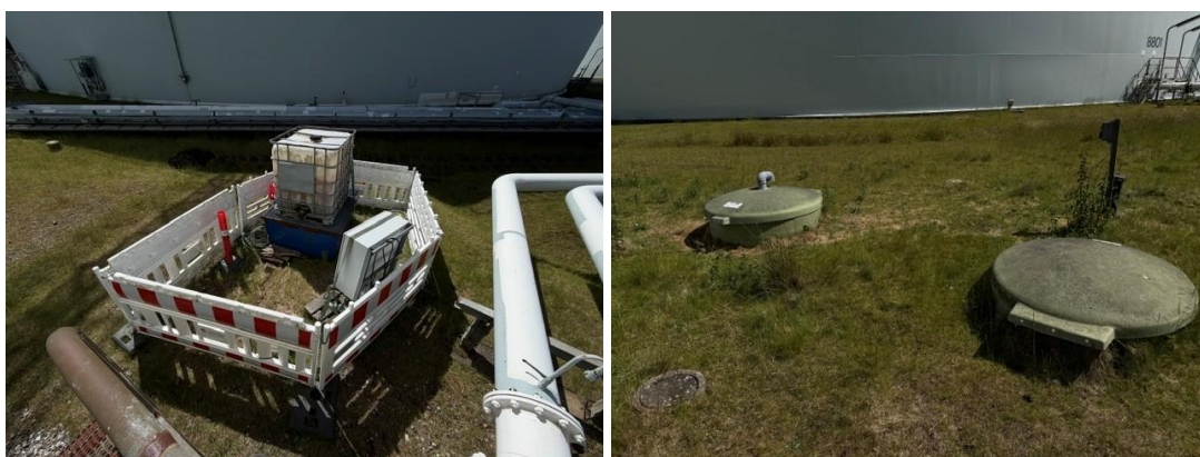
Figur 4. Afværge anlæg og dræntank T-8807
