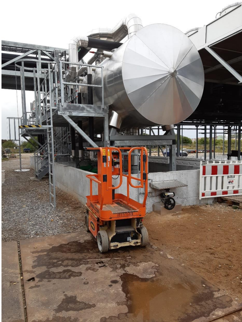
Ammoniaktank til varmepumpe er sikret mod påkørsel
