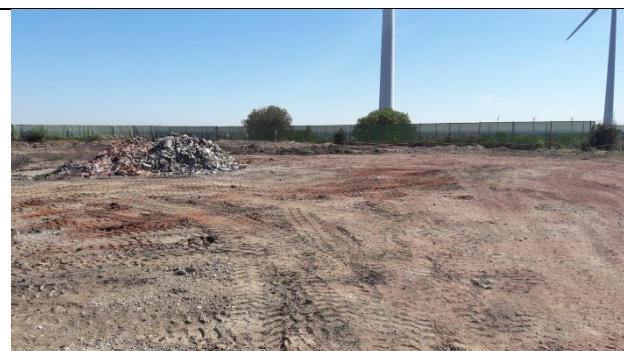
7. Taget ved tipfronten mod det NØ-lige hjørne med støvafskræmning på hegnet. Bunke af tagplader/brokker til afdækning og køreveje.
