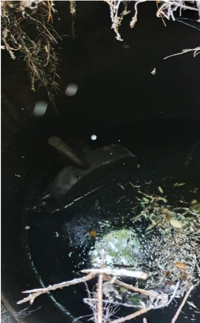
Vandbremse før olieudskiller på nordlige afløbssystem.
