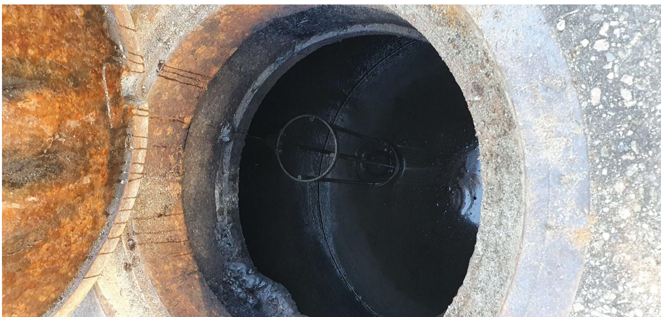
Olieudskiller på sydlige afløbssystem med flydelukke tilledes overfladevand fra udendørs påfyldningsplads ved hal 1.
