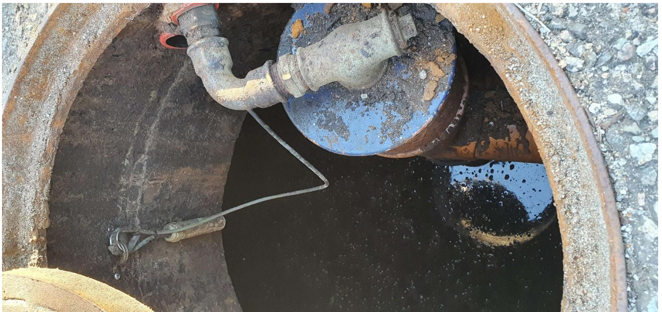
Akkumuleringatank med akustisk overfyldningsalarm på det nordlige afløbssystem. Tanken fungerer også som olieudskiller og er placeret inden en brønd med vandbremse og efterfølgende olieudskiller.
