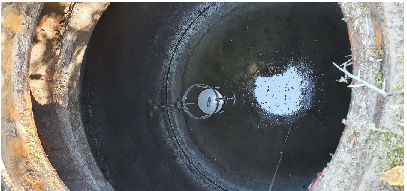
Olieudskiller på nordlige afløbssystem med flydelukke tilledes overfladevand fra pladsens regnvandsbrønde samt brønd ved aflæssepladsen ved udendørs tankgård.
