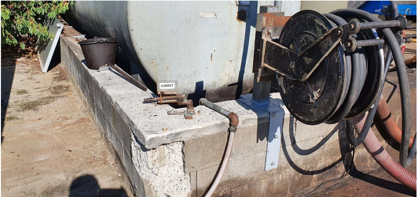
Lukkeanordning på tankgårdsventil er lukket som krævet.
