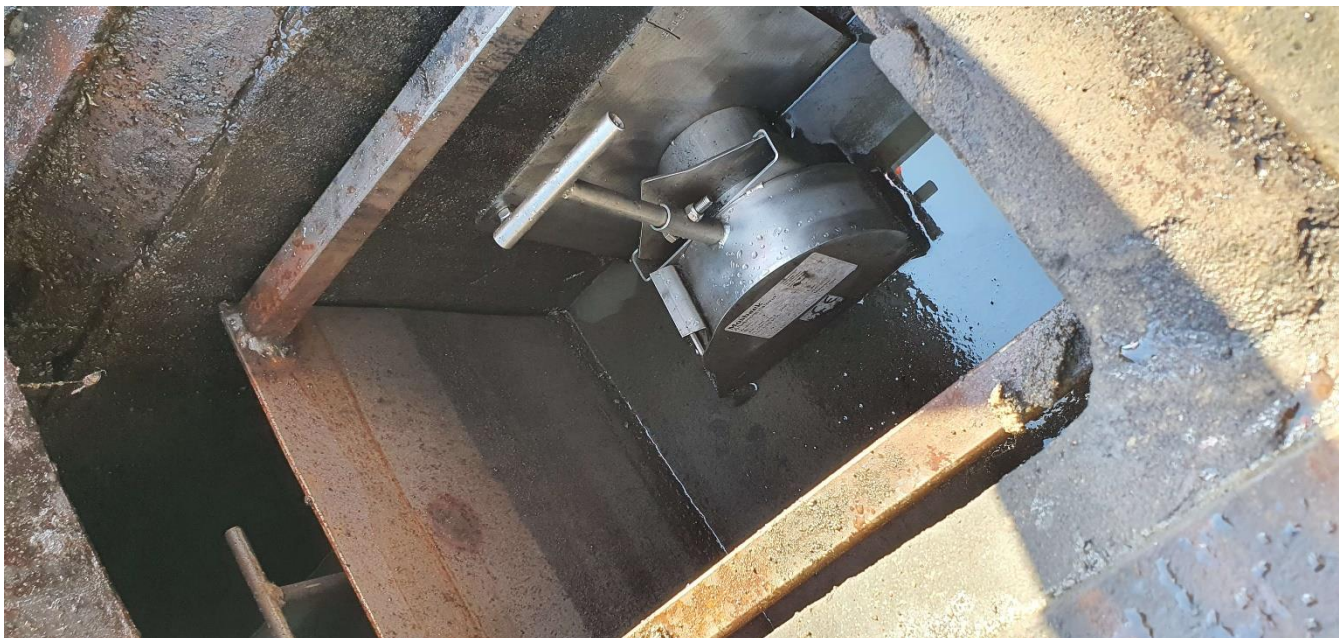
Vandbremse i afløbsrende før olieudskiller på sydlige afløbssystem.
