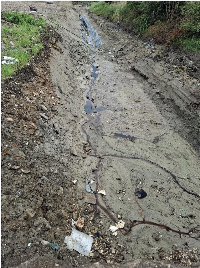
Figur 22. Del af det perkolat påvirkede område langs enhed 1. som sås på tilsynsdag.
