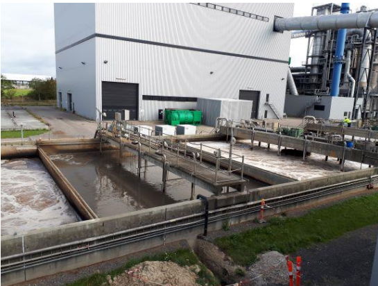
Beluftning gammelt anlæg.
