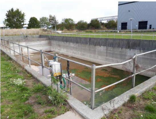
Bassin til regnvandsopsamling. Bassinet har revner og skal renoveres.
