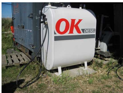
Figur 1: Dieseltank til påfyldning af virksomhedens truck
