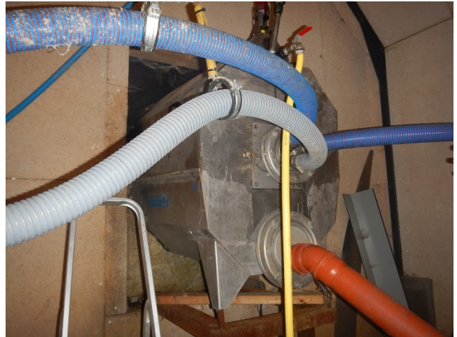
2. Separator. Blå og grå slanger er tilledning af spildevand fra vaskehal. Det orange 110 mm kloakledning er afledning af vand fra separationsanlægget til gulv afløb.
