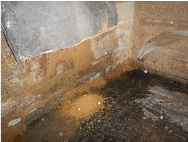
3. Udledning af tørstof (savsmuld) fra separationsanlæg. Hentes herfra med gummihjulslæsser til ladvogn. Der var ingen markant lugt at spore.
