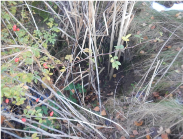
1. Kig ned i § 3 beskyttet vandhul, hvor der jf. kloaktegning er tilledning af tagvand fra overløb
