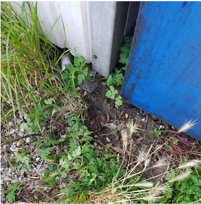
Misfarvet jord ved olietankens bund.
