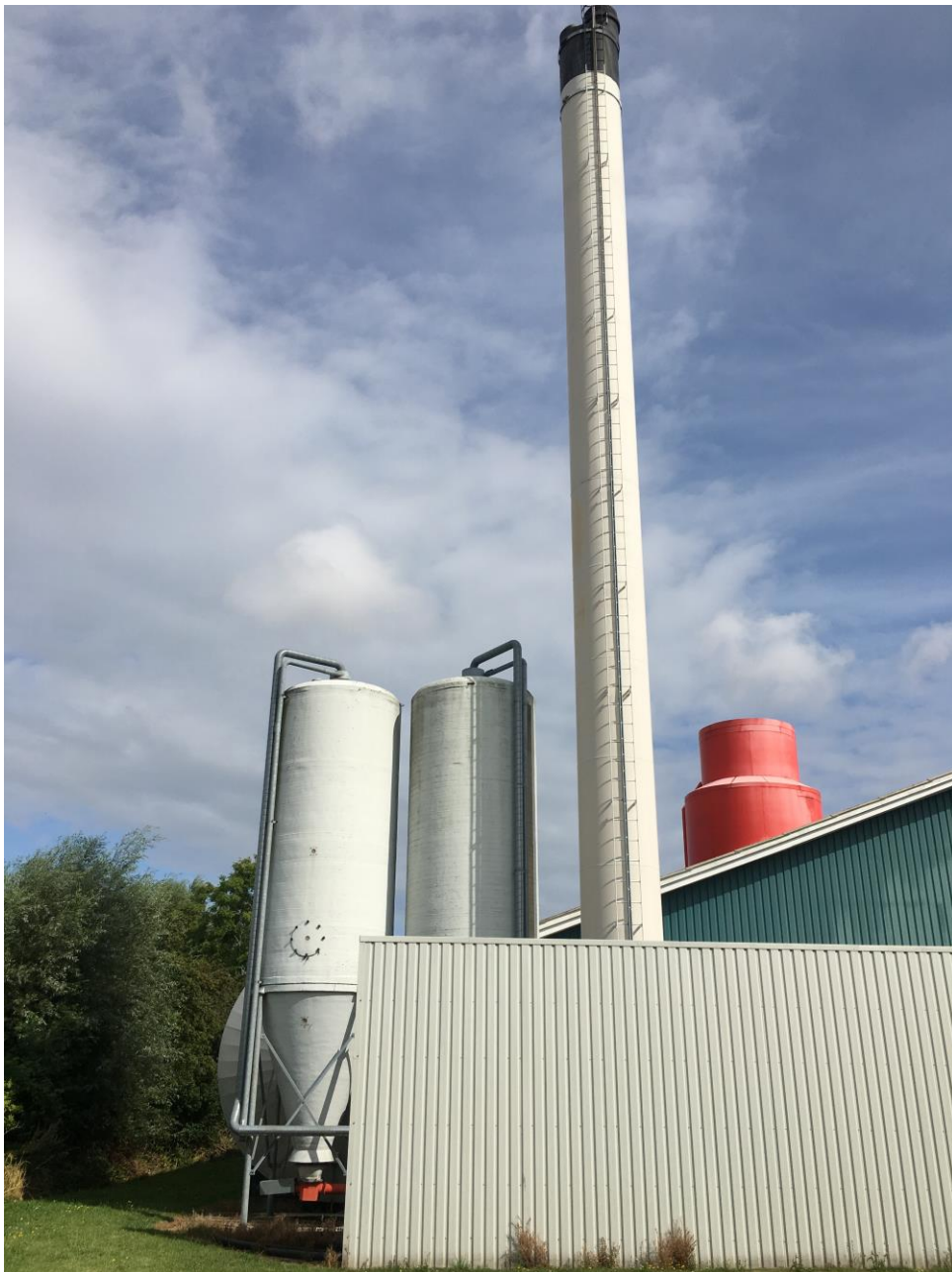
Siloer til træpiller etableret i 2012
