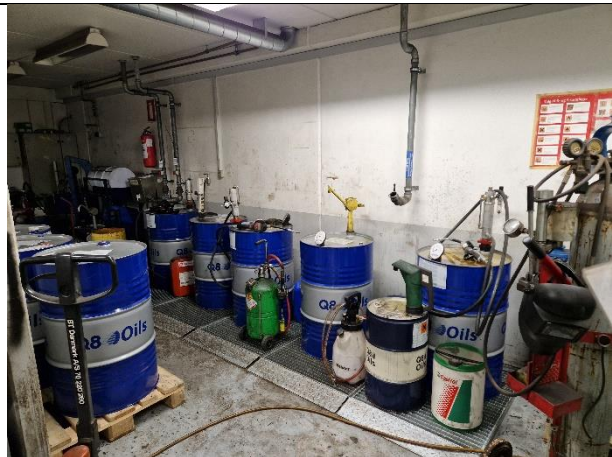
Foto 3. Opbevaring af nye olie på spildbakke. Ok.
