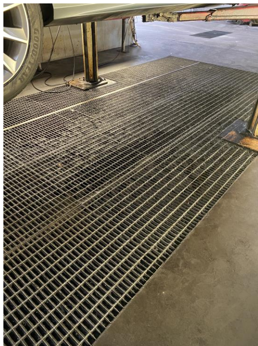
Kar uden afløb til opsamling af overskydende undervognsbehandlingsprodukter
