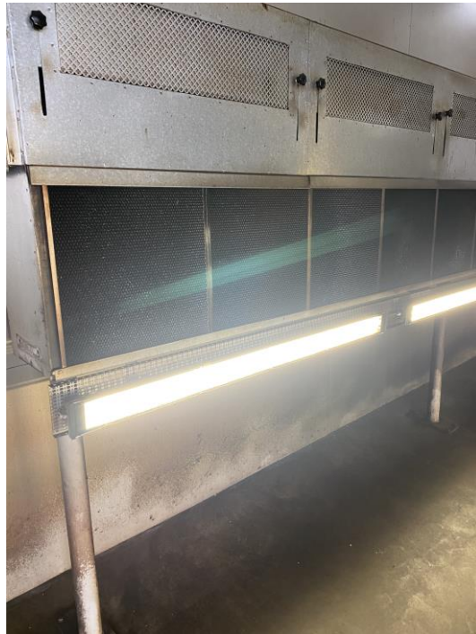
Udsugning i kabine
