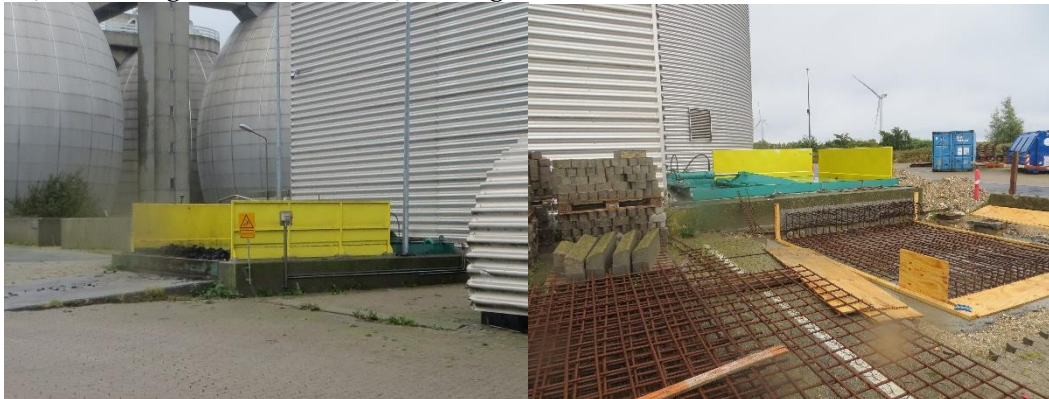
Tv eksisterende indtag af vådslam. Th der var igangsat en ændring af anlægget således at der kunne tilføres slam af to veje.
