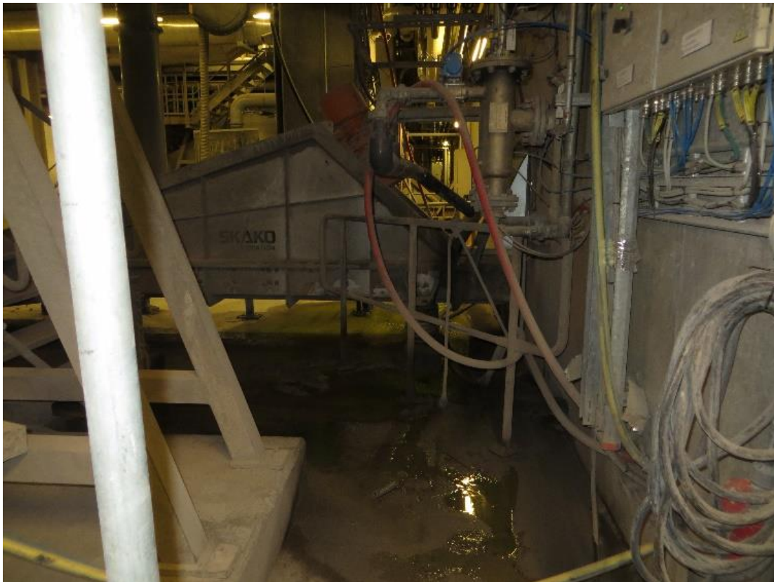
Der var meget vandspild i slaggekælderen
