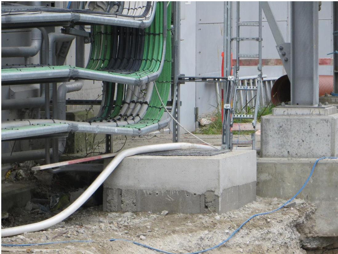
Lukket betonkar til haner t.v. betonfundament t.h.
