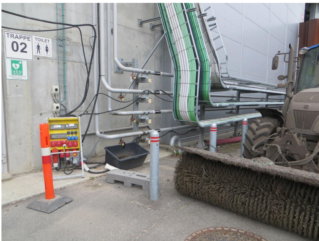
Rørføringer ved trappe 02 er beskyttet mod påkørsel.
