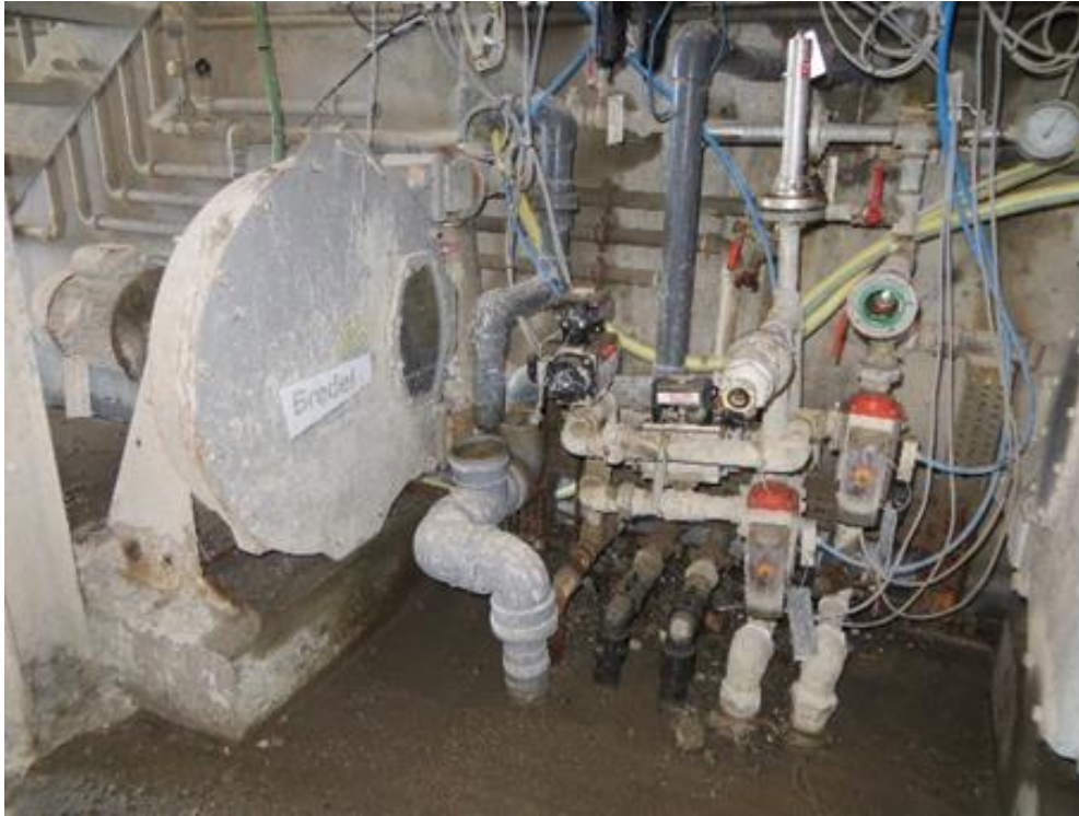
Anlæg og motor til slaggekølevand i slaggeporten. Fremstår ikke velholdt.
