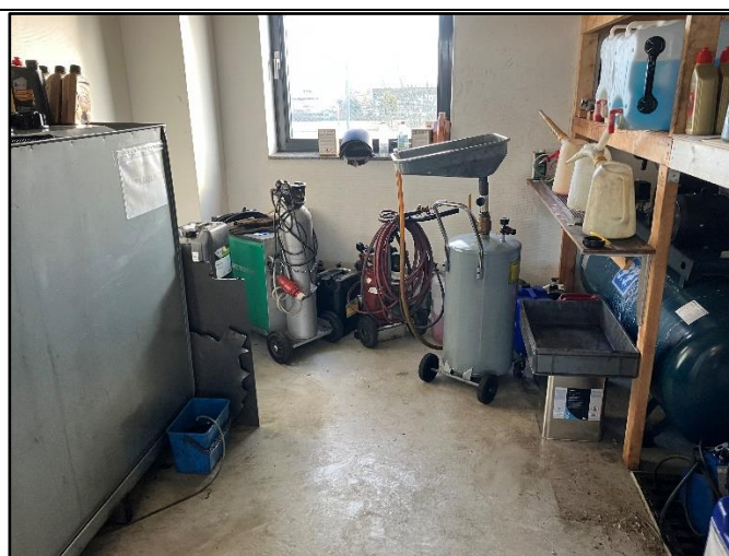
Opbevaring i olierum uden afløb
