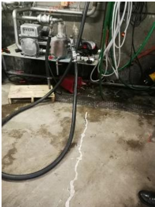
Billede 1 Spild af kemikalier på gulv ved tappemaskine Billede fra tilsyn 2019.
