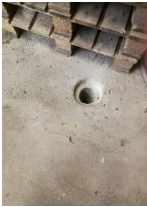
Afløb i lagerrum, hvor der også oplagres råvarer uden spildbakke
