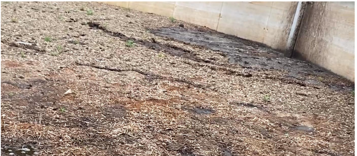
Gyllebeholder, dykket indløb
