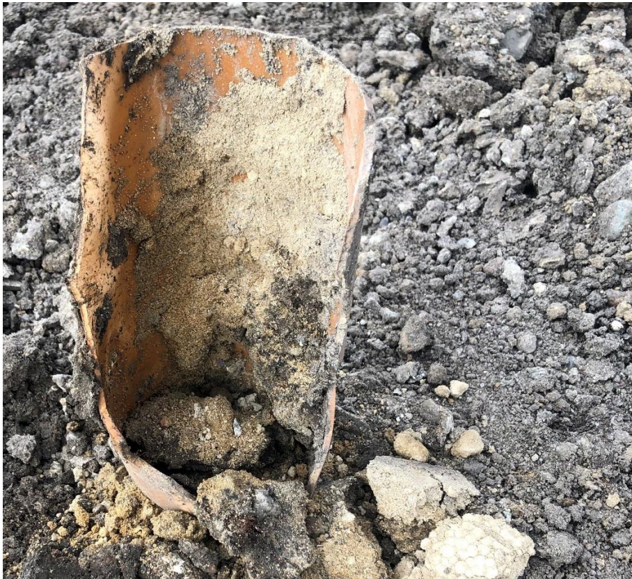
Billede 5. Ødelagt drænrør
