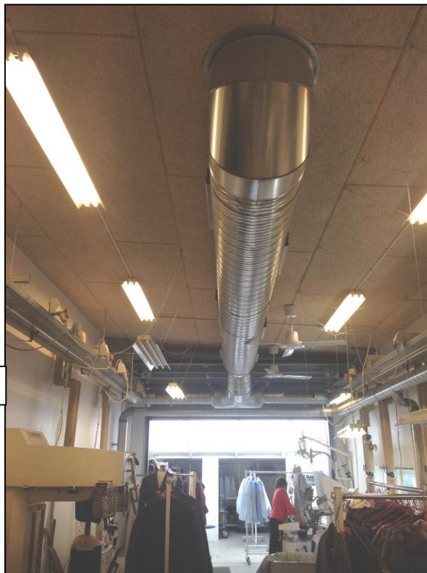
Ventilationsrør i finish-afdelingen
