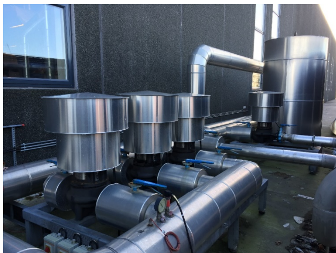
Støjafskærmning om dele af køleanlægget, den 24. november 2016.
