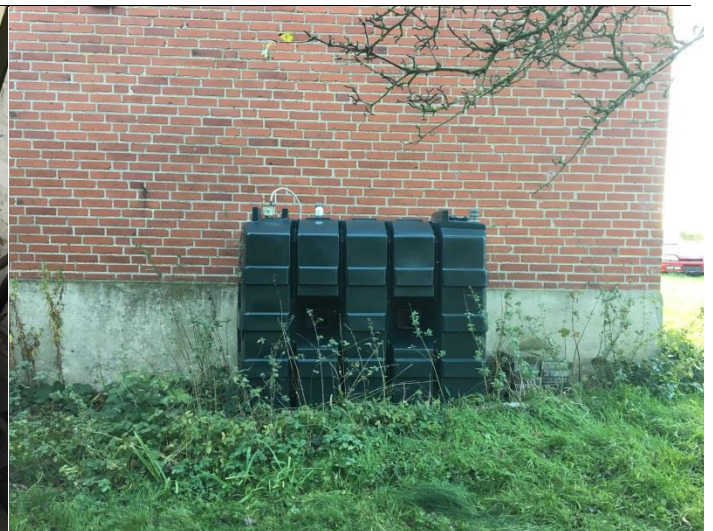
2. Fyringsolietank til boligen.
