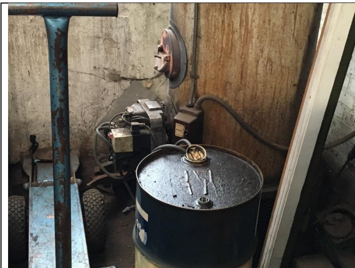
1. Tilførsel af olie til oliefyr på værksted
