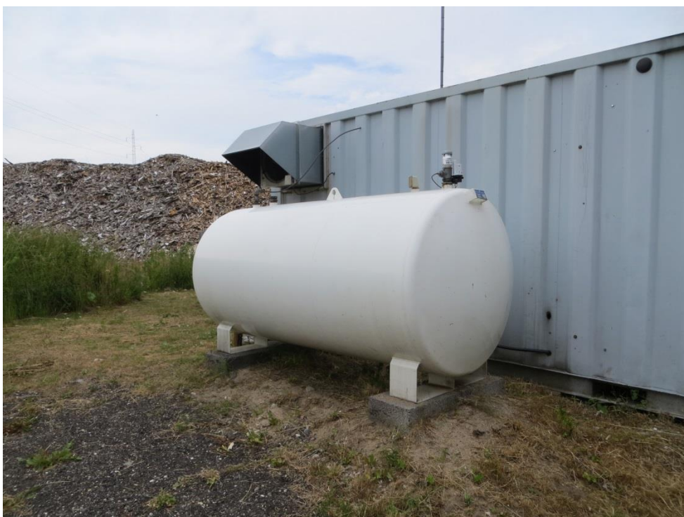
Fritstående olietank ved siden af gasmotoranlæg på den nedlukkede deletape 7.
