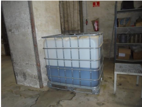
Pallettank til opsamling af olie fra udsugningen over presserne.
