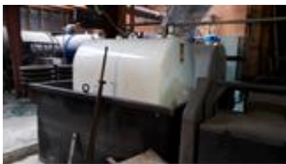
1800 l tank til dieselolie og 1800 l tank til transformerolie
